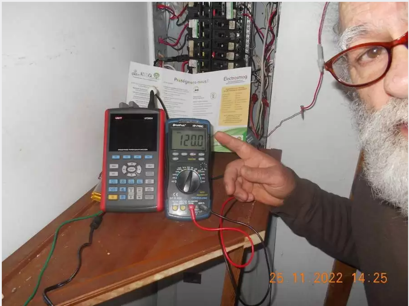
Jean Gagnon mesurant les harmoniques entre le câble neutre (de retour) et la mise à la terre.
